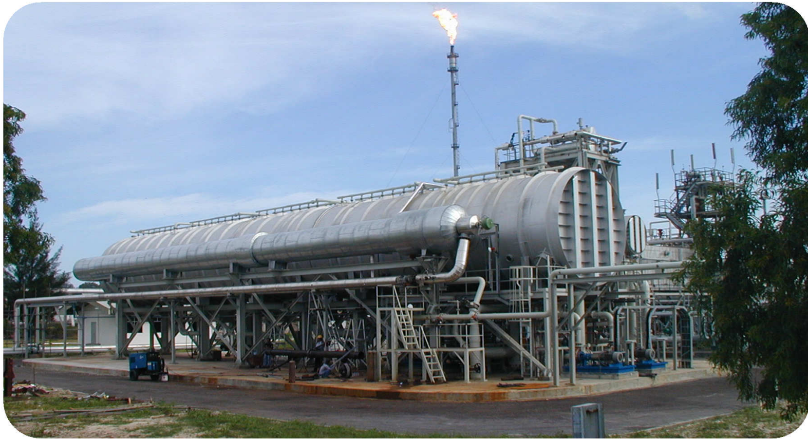
Pertamina Balikpapan, Thermal Desalination, Indonesia
